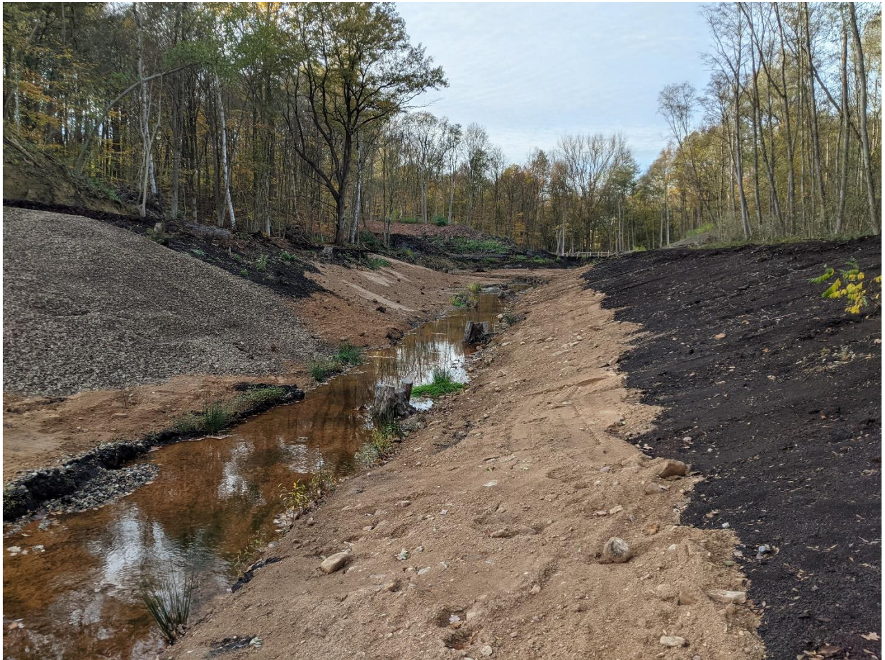
Foto HGN Herbst 2022 Sicherung der Böschungen mit Wandkies zum Schutz vor Bodenerosion
